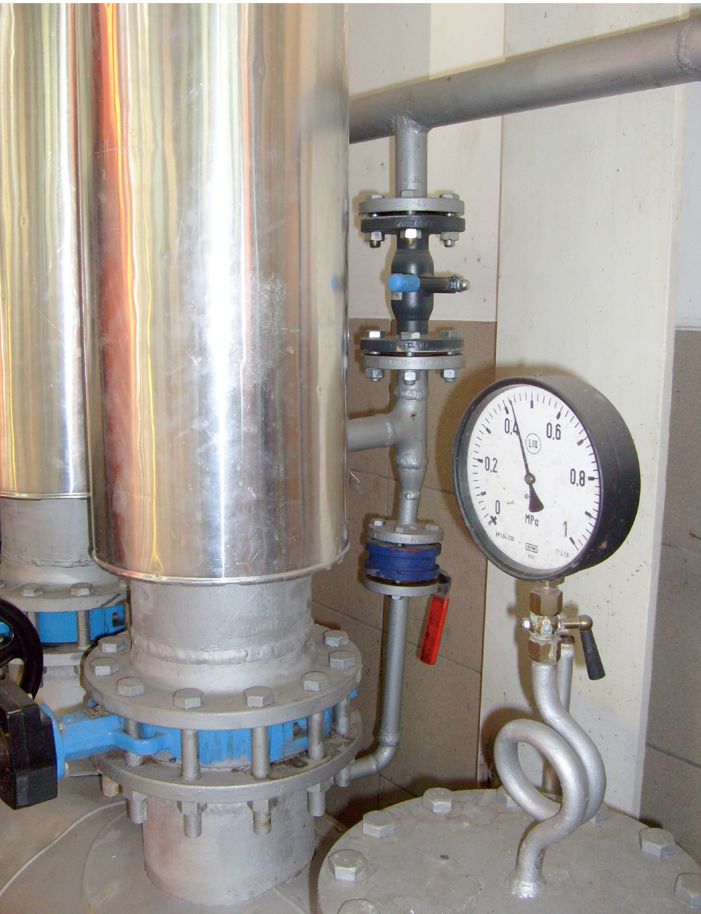
Dodatkowa armatura na kolektorze wlotowym do kotłów
