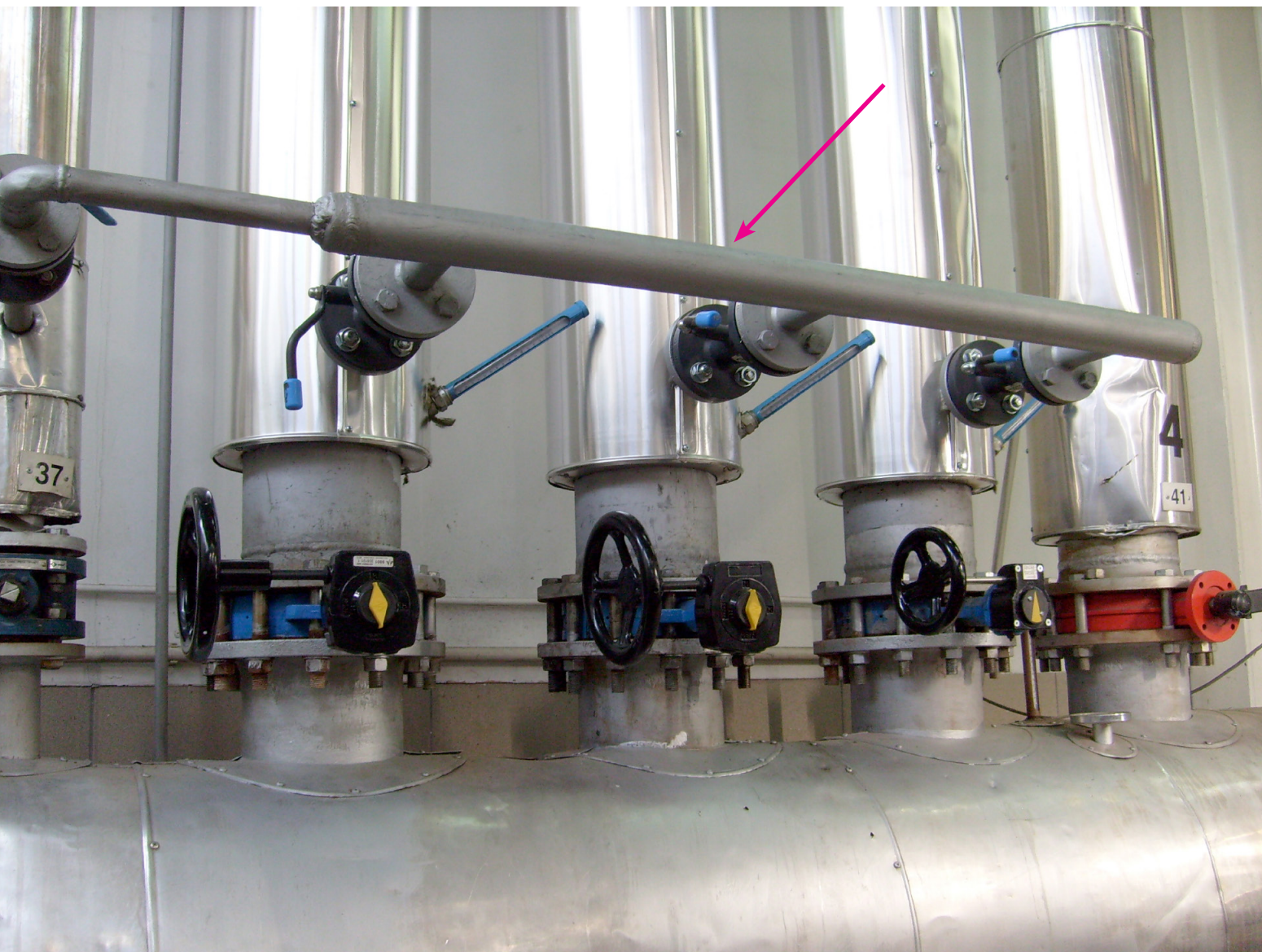
Dodatkowy kolektorek na wylocie z kotłów umożliwiający ładowanie 2 kotłów w czasie pracy jednego kotła
